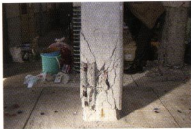
1 せん断破壊試験後、補修前状況 柱状供試体 (製作時 N-02)
